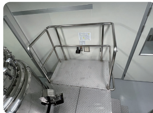
► 2025 目標改善方案-投料平台增設護欄避免人員不慎踏空自平台上跌落
