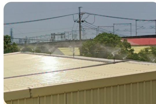
自來水水處理砂濾塔逆洗用水回收使用於廁所沖水及雨水回收儲留用於中午時段噴灑屋頂降溫，以降低空調用電需求。
