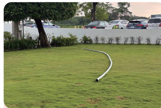
雨水儲留新增管路供應中央草皮澆灌使用，減少自來水耗用量。
