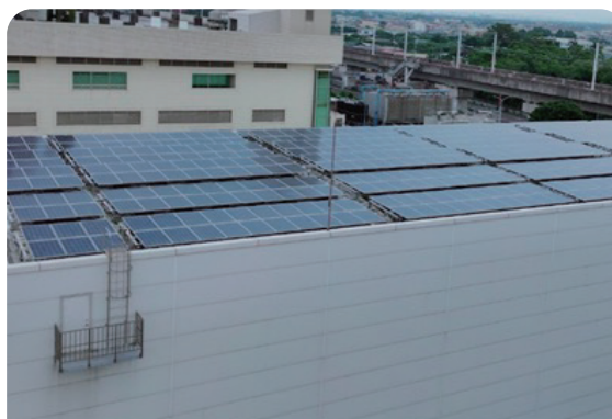
屋頂型太陽能第一期及第二期已完工多時，持續穩定發電。
