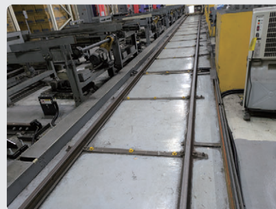
▶ 內部台車軌道凸起點以黃色油漆進行標示，提升辨識度。
